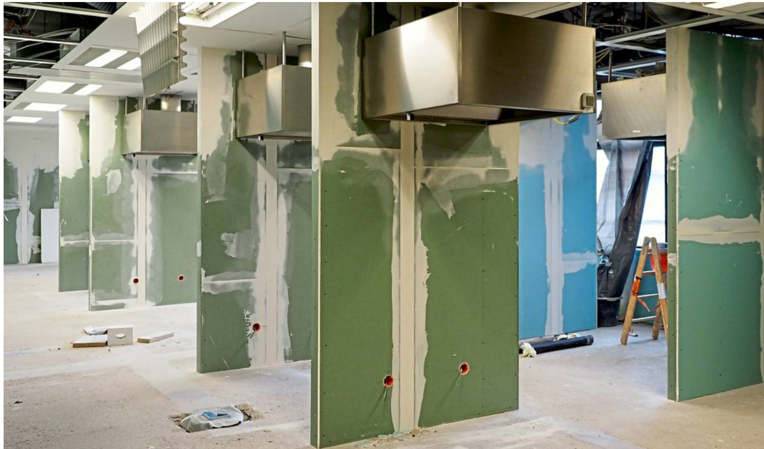
Hier entsteht die Küche des Bereichs, in dem die Flüchtlinge untergebracht werden.
